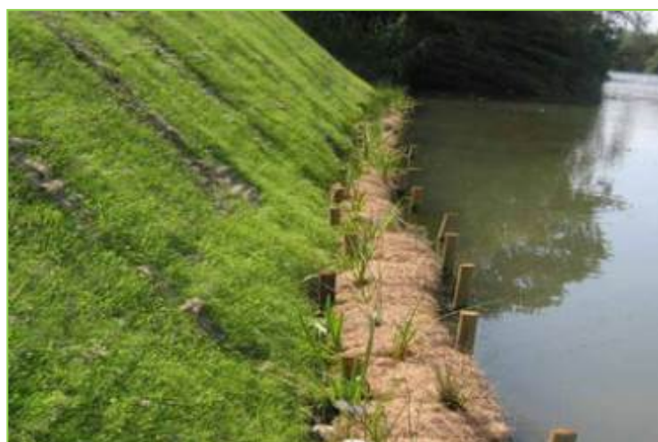
Figure 172 – Boudins de fibres de coco pour la protection de berges © biogreensolutions.fr – Photographie prise hors site.
