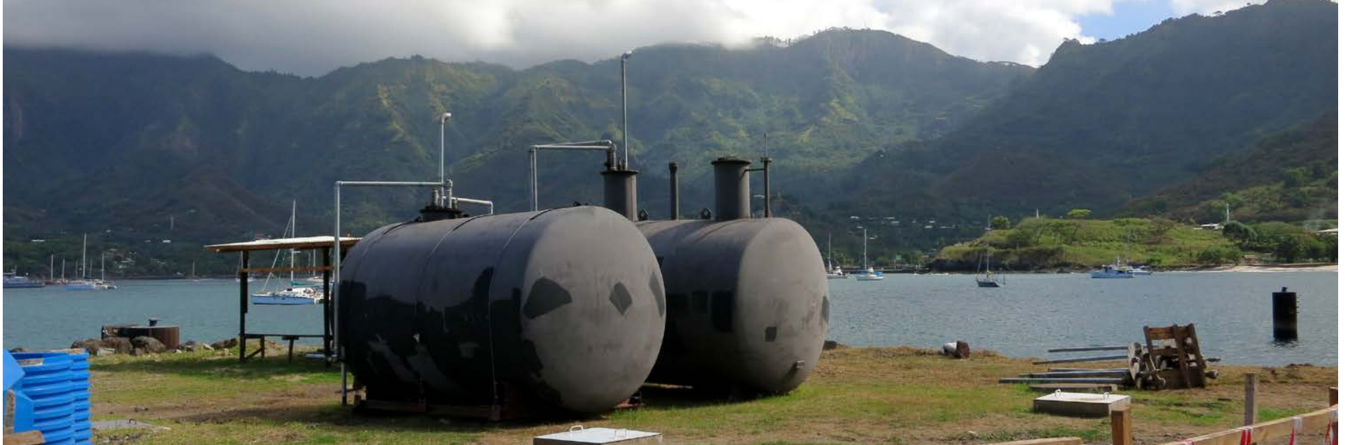
Cuve de station service à Taiohae (Nuku Hiva) © M. Preuvost / AAMP
