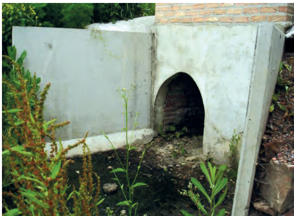
Figure 51. Exemple de passage à amphibiens installé sous une piste dans un site industriel.
